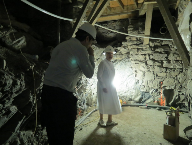
Sœur Lise Tanguay en plein chantier, dans les voûtes du Monastère des Augustines.
